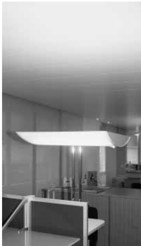
Bild 110 Gute Leuchte für Bildschirmarbeitsplätze in einem Kombibüro: Ständerleuchte, direkt-indirekt strahlend.
