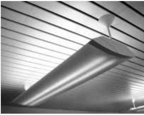
Bild 112 Gute Leuchte für Bildschirmarbeitsplätze: Deckenleuchte, direkt-indirekt strahlend.
